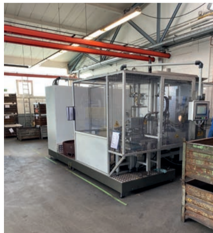
Induktive Härteanlage, welche im Frühjahr 2019 in Betrieb genommen wurde.
